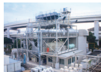
コ・ジェネレーション設備 Co-generation system
